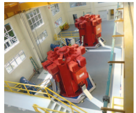
Salle des machines de la centrale hydroélectrique de Sabangan
