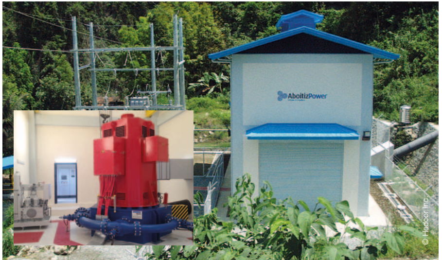
▲ Vues de l'extérieur et de l'intérieur de la centrale d'Irisan 1
